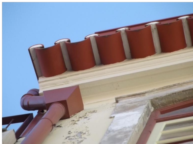
Figura 4.8 – Problema de Humidade Junto a Cornija
