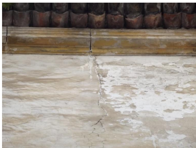
Figura 4.6 – Exemplo de Fissuração num Edifício da Rua Fernandes Tomás
