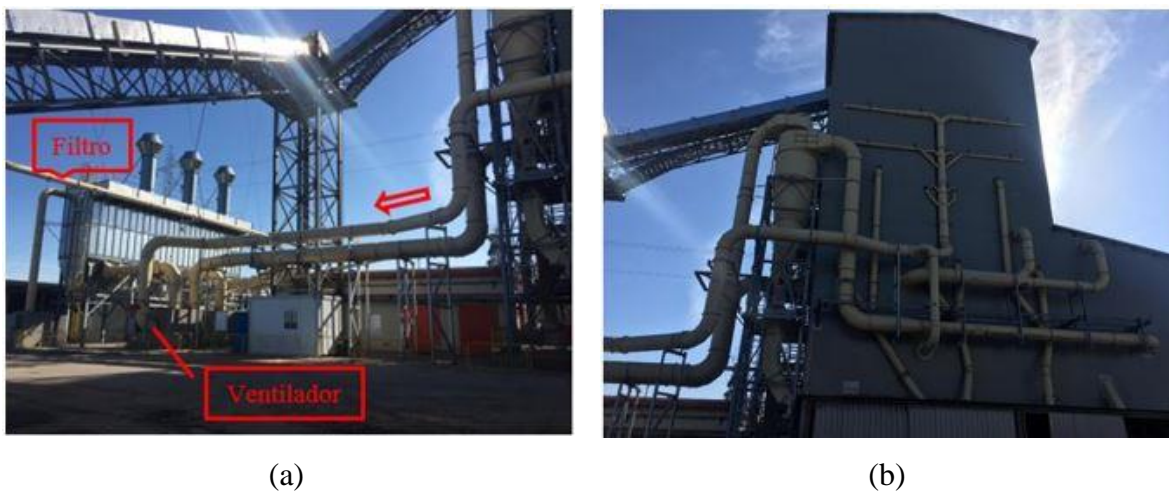
Figura 4.6. (a) Unidade filtrante; (b) Canais de aspiração de despoeiramento.
