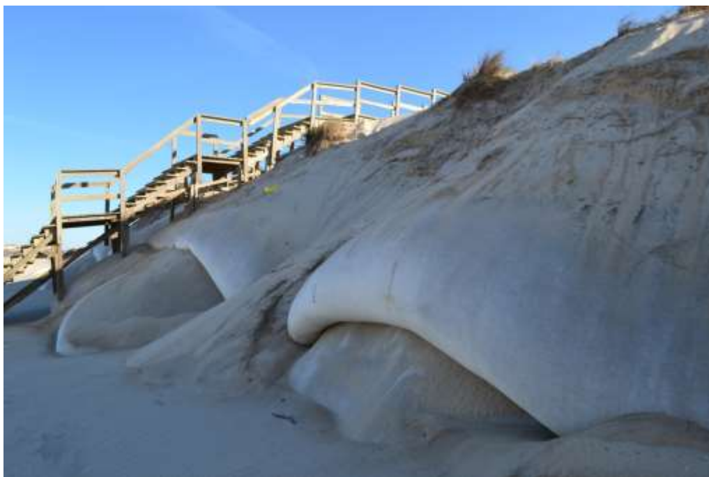
Figura V. 30- Geotêxteis de proteção ao emissário submarino da Leirosa, expostos em função da ação erosiva decorrente do avanço do mar. Fonte: Wendson Medeiros, janeiro/2012.
