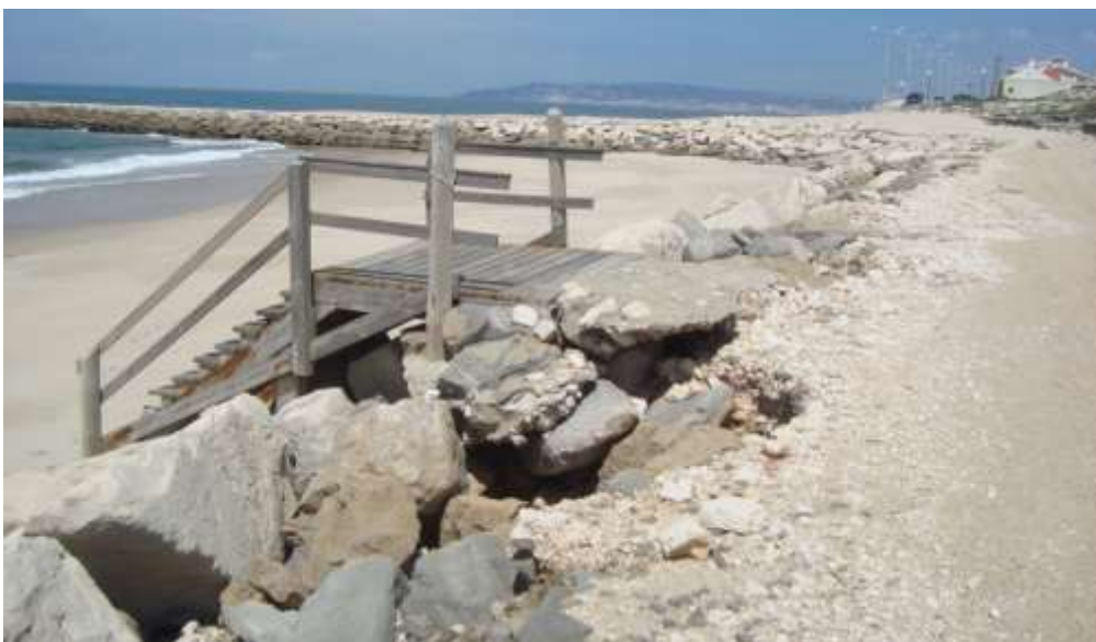
Figura V. 14- Erosão a sul do esporão da Cova-Gala ameaçando a estrutura do enrocamento do próprio esporão. Fonte: Wendson Medeiros, maio/2012.
