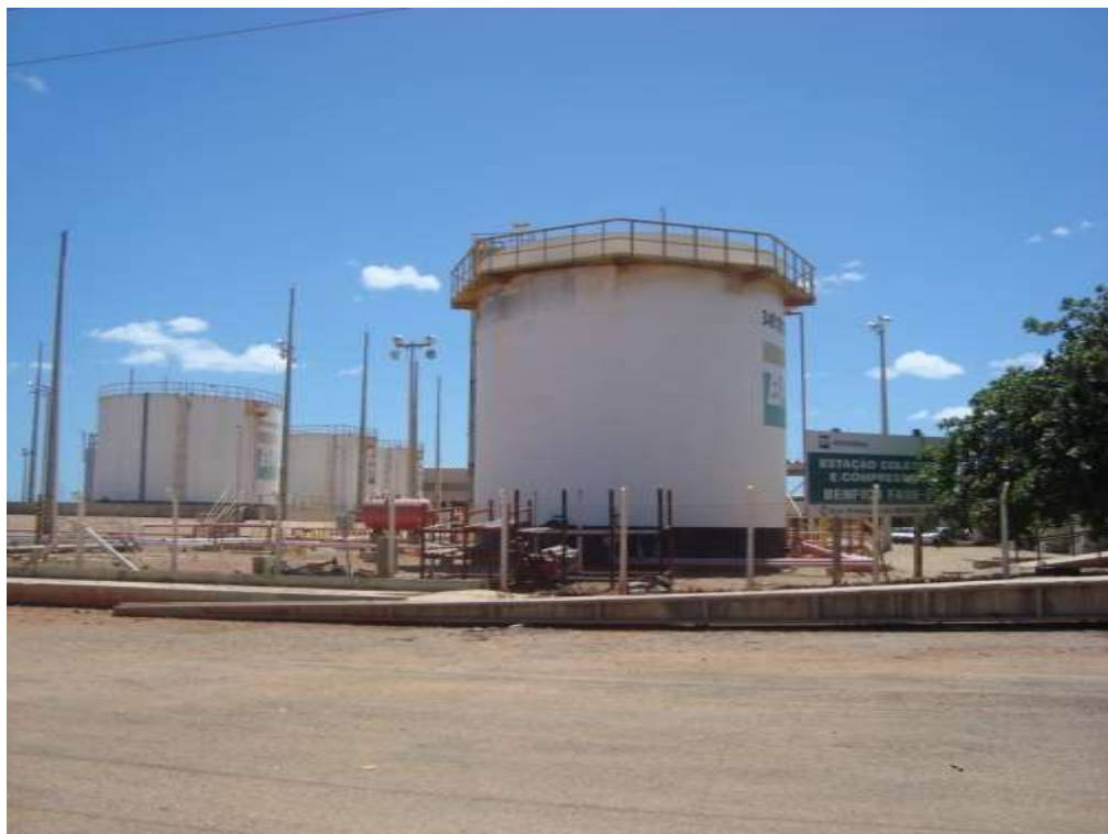
Figura IV.22- Aspectos de uma estação coletora e compressor de óleo instalada em área de caatinga, na localidade de Benfica, município de Areia Branca. Fonte: Wendson Medeiros, agosto/2010.
