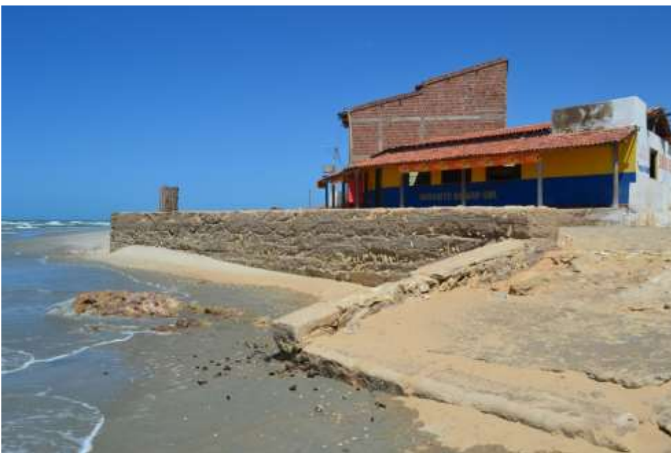
Figura IV.35- Muro de contenção das águas do mar com intuito de reduzir as inundações na comunidade de Mel de Baixo. Fonte: Wendson Medeiros, fevereiro/2013.
