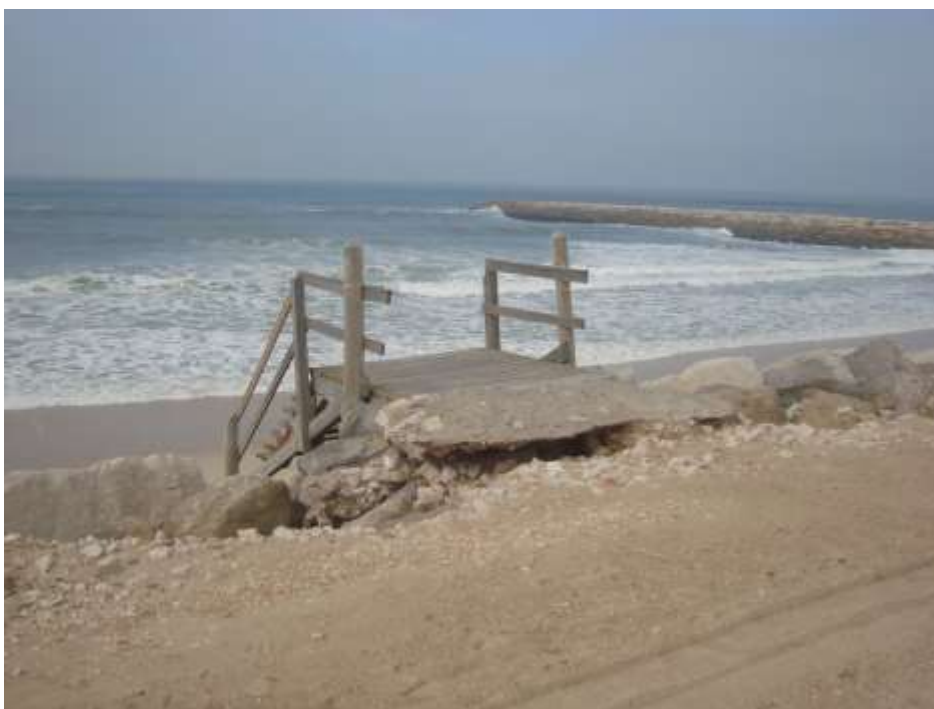
Figura III.3- Destruição de escada de acesso à praia na Costa de Lavos, por ação do mar. Fonte: Wendson Medeiros, novembro/2010.
