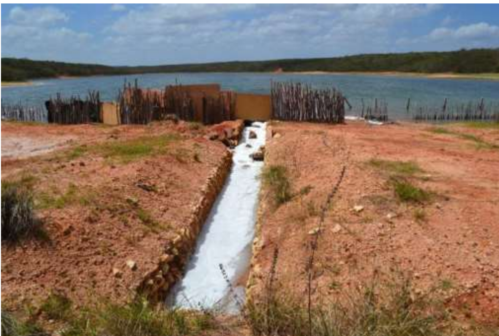
Figura IV.26- Aspectos do bombeamento utilizando sistema de drenagem da estrada para enchimento do reservatório de água doce com águas salinas. Fonte: Wendson Medeiros, agosto/2011.
