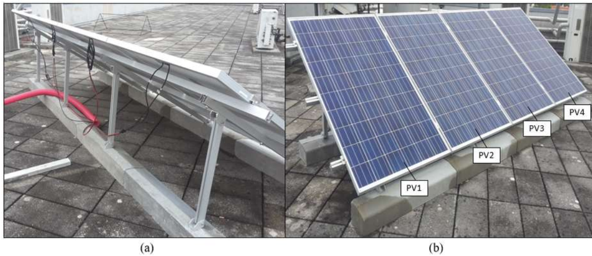
Figura 2.1. Instalação experimental (parte exterior) situada na cobertura do LAI-ADAI.
