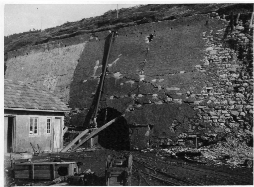
Fig.1.93 Fleury, Ernest, Fissuração da entrada da Galeria Nova Mondego em Janeiro - in - Fleury, Ernest Joseph Xavier. 1941. Op, Cit.
