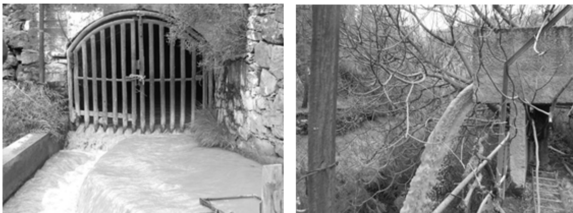
Figura 3.5- Saída da água na boca da mina (junto à estação de tratamento da Salgueira), e à dtª descarga direta na ribeira do Bodelhão sem tratamento. Foto do autor 30.03.2011.
