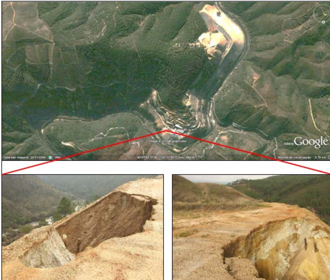
Figura 4.20 - Cicatriz provocada na escombreira abandonada por um deslizamento de material de grande volume no Cabeço do Pião, que terminou no rio Zêzere (fotos do autor em 2007)
