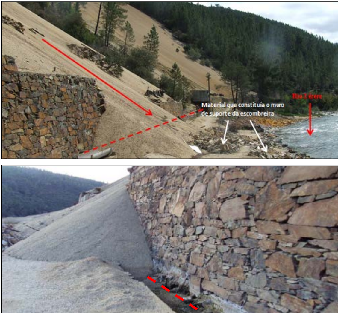
Figura 4.25 - Fluxo de estêreis na escombreira do Cabeço do Pião que sustenta a barragem de lamas e que rompeu com o muro de suporte que o separa do rio Zêzere. Resteva Norte. O tracejado vermelho corresponde ao canal de recolha de AMD, obstruído (foto do autor 30.03.2011).
