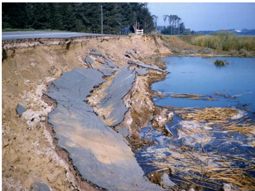
Fig. 4-10 – Rotura de fluxo desenvolvida no bordo de uma estrada junto ao lago Merced em São Francisco, durante o sismo de 1957 (Fotografia de M. G. Bonilla dos USGS in www.usgs.gov ).
