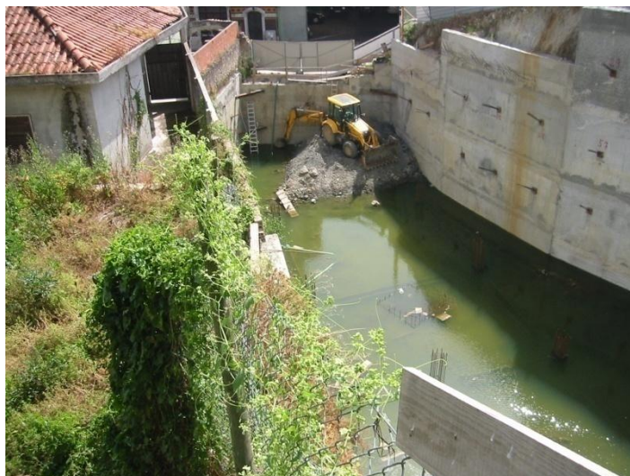
Fig. 3-13 - Presença de água nas fundações de um edifício na baixa aluvionar do rio Liz.
