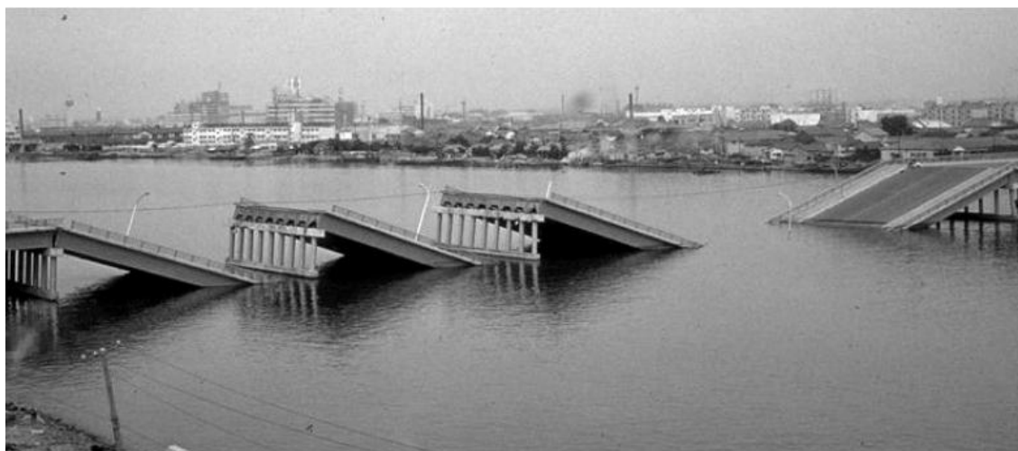
Fig. 4-8 - Rotura das fundações da ponte sobre o rio Showa por espalhamento lateral, Niigata, Japão (Kramer e Elgamal, 2001).
