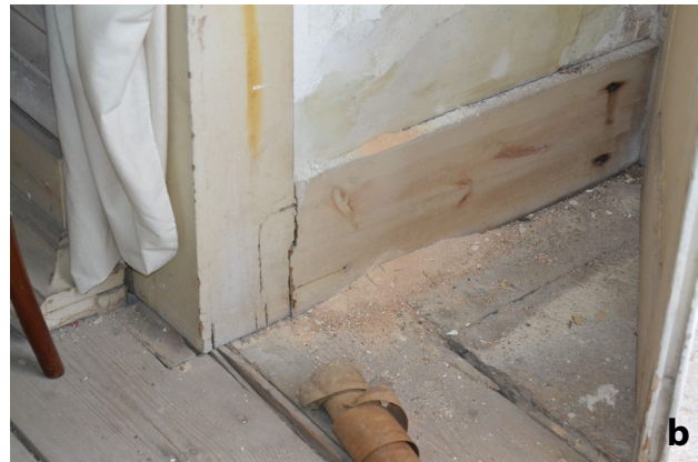
Figura 3. Degradação localizada da alvenaria devido à ação da água.
